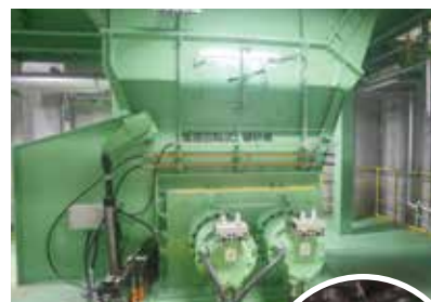
低速回転式破砕機 受入ホッパに投入されたごみは、低速で回転する破砕機により、約30cm以下に破砕処理します。
