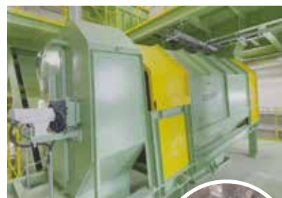
粒度選別機 破砕物を回転する円筒のふるいにかけて、粒度差によって不燃残渣と可燃残渣に分別します。
