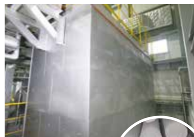
バグフィルタ 消石灰と活性炭を吹き込んだ排ガスをろ過し、排ガス中に含まれる塩化水素、硫酸化物等の有害成分を飛灰と共に取り除きます。
