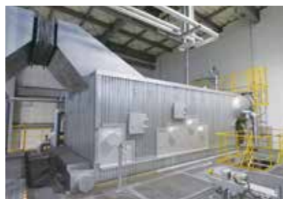
ボイラ 焼却炉から発生した高温の排ガスの熱を利用して蒸気をつくります。蒸気を高温高圧(4MPa,400℃)とすることで、排ガスの熱エネルギーをできる限り回収します。
