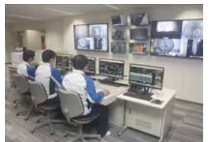
中央制御室 プラント設備全体の運転状況を集中監視および制御しています。各設備は最先端の制御システムにより自動運転されています。
