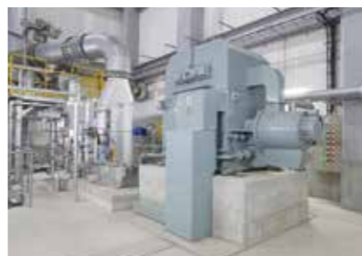
蒸気タービン・発電機 ボイラで発生した蒸気を利用し、基準ごみ2炉で1400kWの発電を行い、施設内の電力に利用するとともに余剰電力は売電します。また、交流拠点施設温水プールへの温水供給も行っています。
