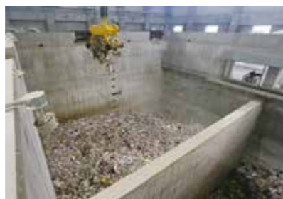
ごみピット・ごみクレーン 受入部と貯留部の2段階ピット方式です。貯留部ピットで十分攪拌されたごみはごみクレーンでごみ投入ホップへ投入されます。
