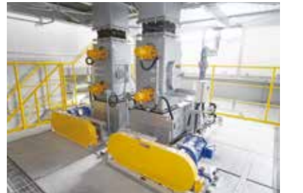
混練機 バグフィルタで捕集した飛灰を薬品で安定化処理します。
